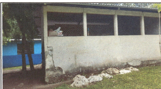
ventanas sin balcones necesita balcones.
