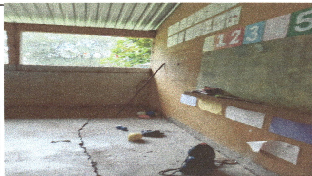
Piso en mal estado necesita sustituir.
