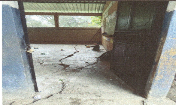
Piso en mal estado necesita sustituir.
