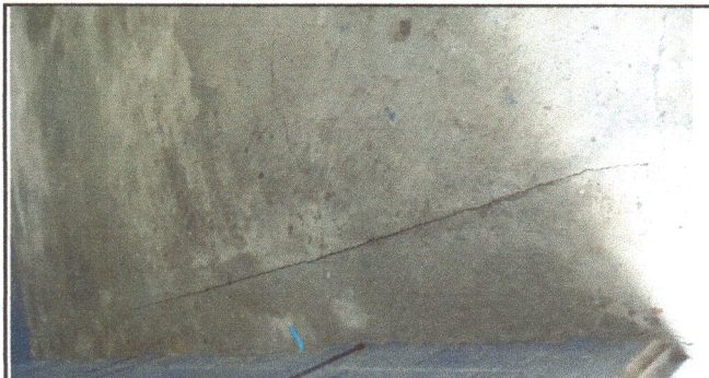
Piso en mal estado necesita sustituir,
