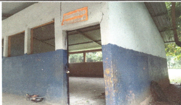
Pared y columna en mal estado necesita sustituir.
